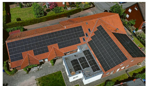
Die Bürgerenergiegenossenschaft hat ihr mittlerweile siebtes Projekt realisiert. Auf dem Dach der Kita Tüllinghoff ist eine weitere Photovoltaik-Anlage errichtet worden.
