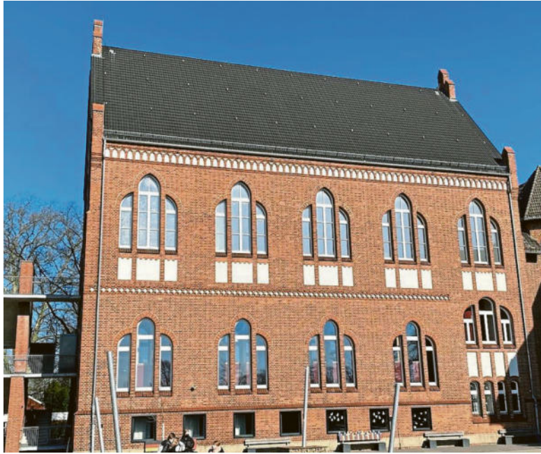
Auf dem Dach der Aula des St.-Antonius-Gymnasiums wird in den Osterferien eine PV-Anlage installiert.
