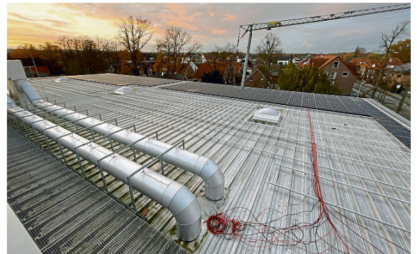
Ihre bereits fünfte PV-Anlage in diesem Jahr hat die Bürgerenergiegenossenschaft auf dem Dach der Sporthalle der Sekundarschule realisiert.
