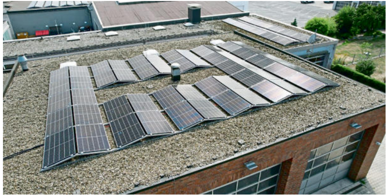
Mit einer Investitionssumme von 54.000 Euro ist diese PV-Anlage auf dem Dach der Feuerwehr installiert worden. Foto: Feuerwehr
